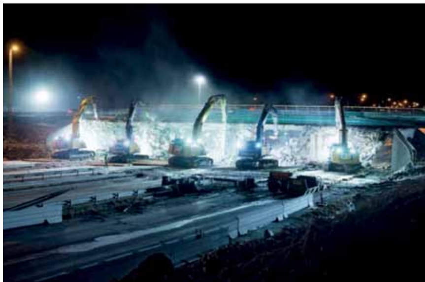
Rivningen av bron orsakade timslånga köer på E18. (Bilder från Täby Kommun)
