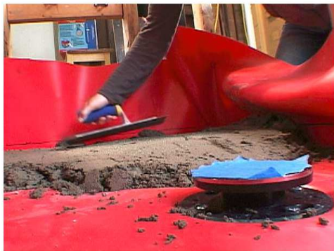
Figur 18 Amerikansk teknik med tjock fuktspärr i form av tätskiktsduk på träbjälklag innan fallgjutning.
